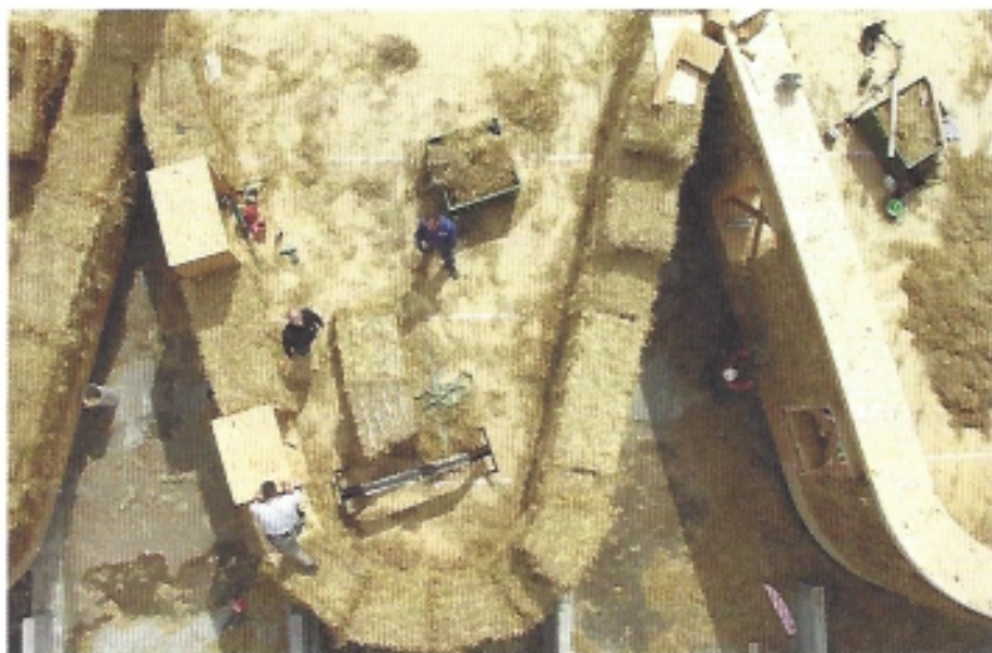
Die Südtiroler Ferienwohnungen im «Esserhof» sind die ersten klimaneutralen Bauten Italiens, hergestellt aus Strohballen des Schweizer Architekten Werner Schmidt.
